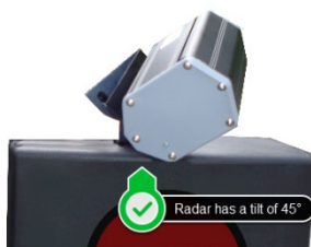
Figura 12: vista de la parte delantera del semáforo. El radar está inclinado hacia la acera.
