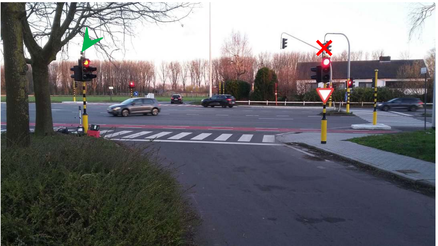
Figuur 20: installatie van de radar op de linkerkant van de voertuigen
